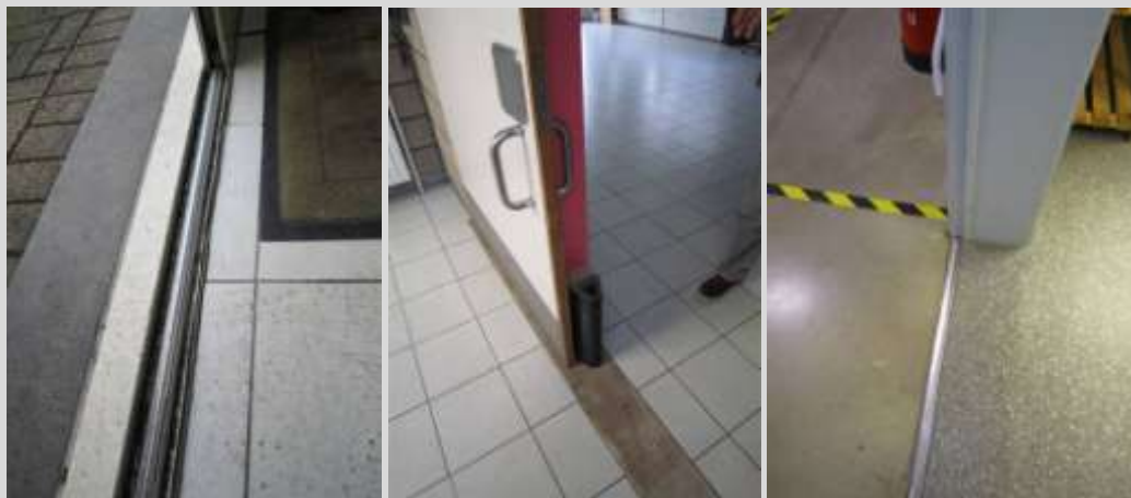
Beschadiging van een raamkader.- beperkte voeg in betegeling van de vloer – overgang verschillende vloerafwerking (let op bij naden).
