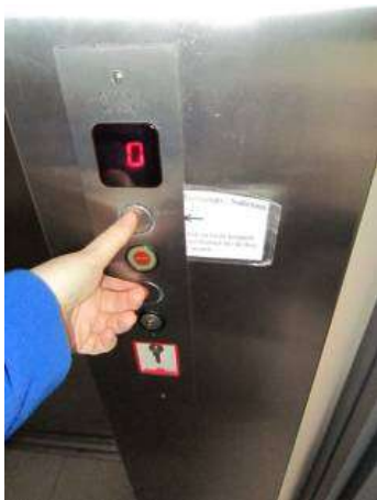
De toegang tot de lift is beveiligd doordat je twee knoppen tegelijk moet indrukken. De gasten kunnen dit niet waardoor ze geen gebruik kunnen maken van de lift. Maria ter Engelen, © Enter vzw
