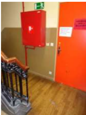
Voorbeeld van een zeer slechte plaats voor een brandhaspel.
