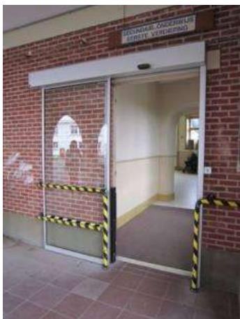
Bescherming van de glazen deur tegen stuk rijden: ijzeren kader met waarschuwingsmarkering.
