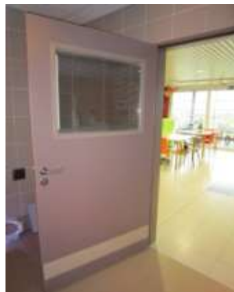
Raam in de deur, afsluitbaar met ingewerkte jaloezie.
