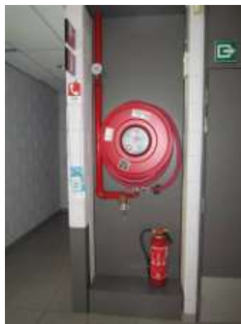
Brandhaspels en blussers zijn ingewerkt in nissen en op vloerniveau gesloten.
